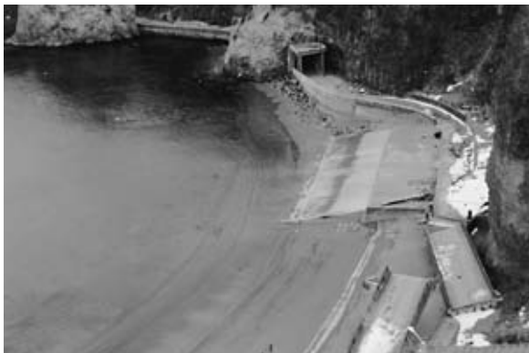
海岸線の道路は復旧が遅れている箇所もあります
