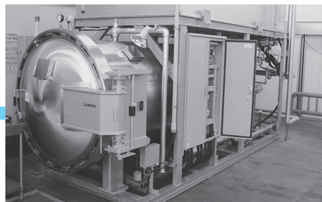
(株)ぎよれん鹿島食品センターに導入されたレトルト機械
