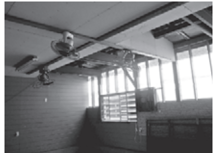
設置する「高さ」がポイントの換気扇 (写真中央の四角い部分)
