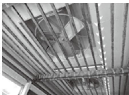
天井に設置された酪農用の大型扇風機（えさん）
